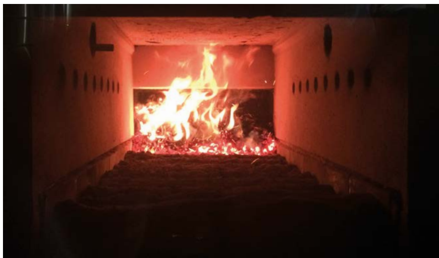
Flamme dans une chaufferie collective. © Fibois Aura.
